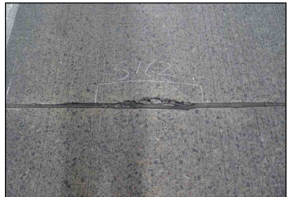
h. 포장부 S162 줄눈 주변 파손
