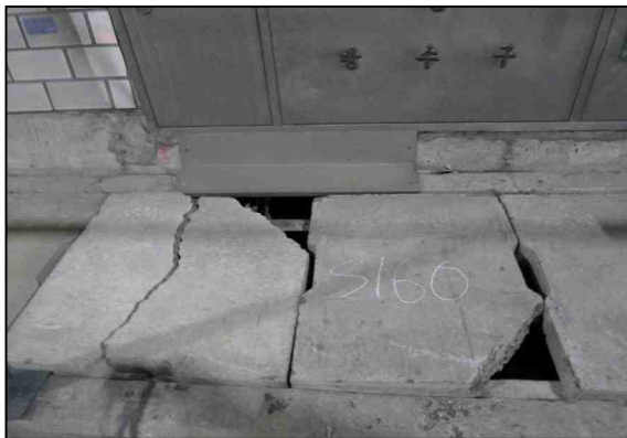
g. 공동구 S160 좌측 덮개 파손
