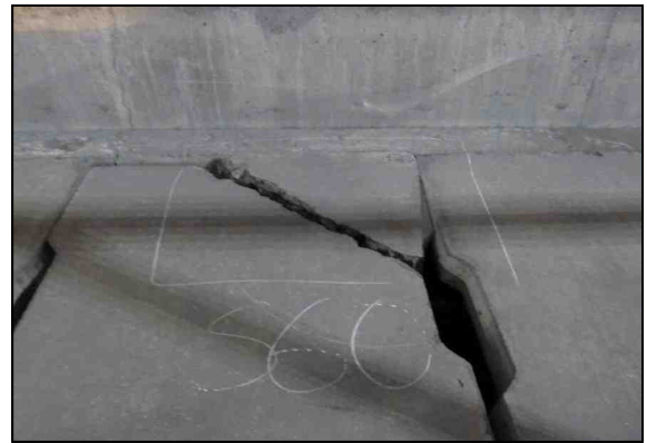
d. 공동구 S60 좌측 덮개 파손
