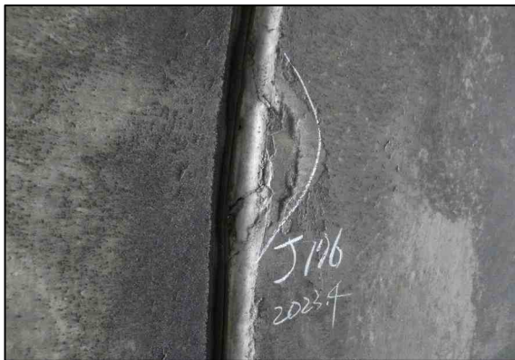
o. 천단부 S176(J176) 시공이음부 박락
