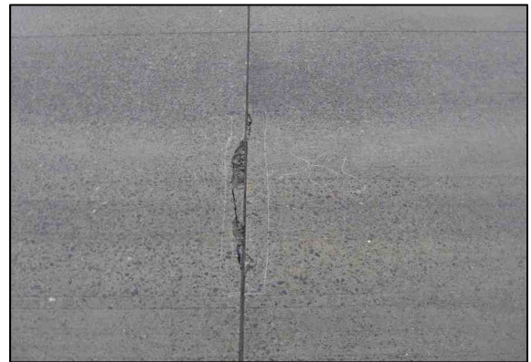
f. 포장부 S65 줄눈 주변 파손
