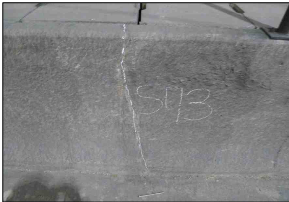
e. 공동구 S73 측면 균열(0.3mm이상)
