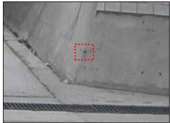
b. 피난연락갱 S128(차도용) 파손
