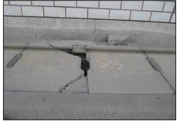
b. 공동구 S23 좌측 덮개 파손
