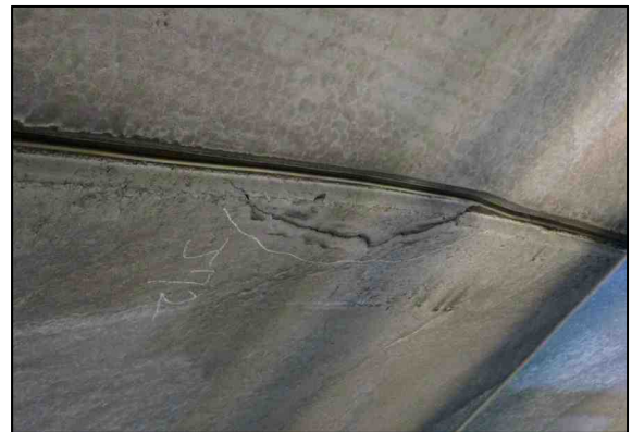
h. 천단부 S72(J72) 시공이음부 박락
