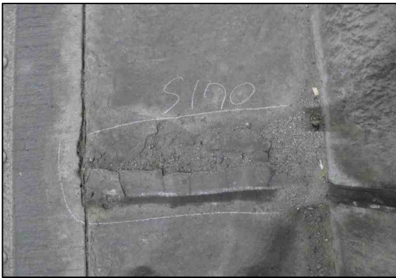
c. 측구 S170 파손
