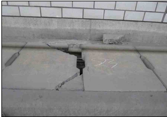
a. 공동구 S23 좌측 덮개 파손
