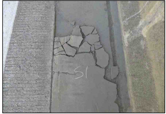
b. 측구 S1 파손
