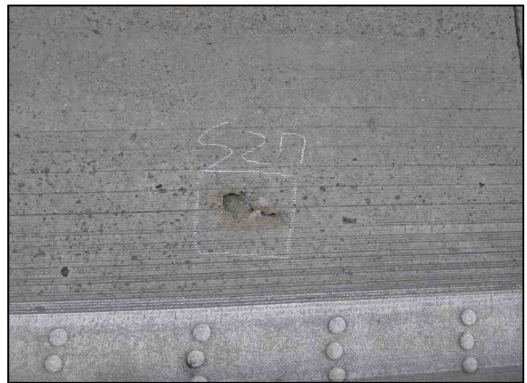
d. 포장부 S27 패임, 파손
