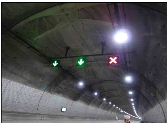
e. 신호시설(통행, 차단) 설치현황
