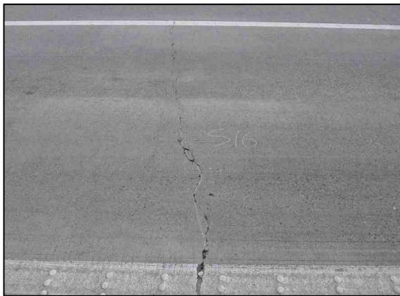
c. 포장부 S16 균열
