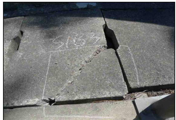
d. 공동구 S183 좌측 덮개 파손
