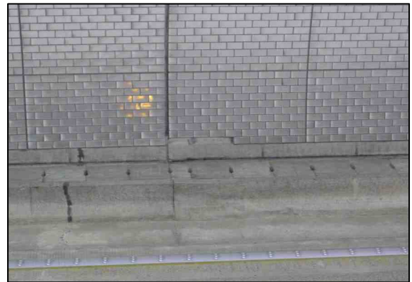
f. 측벽부 S142 좌측 타일탈락, 파손
