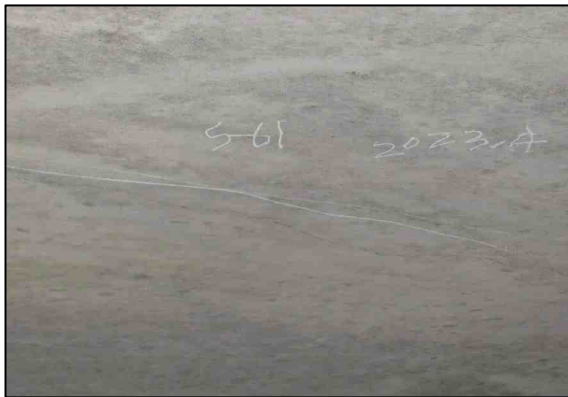
e. 천단부 S61 균열(0.3mm 이상)
