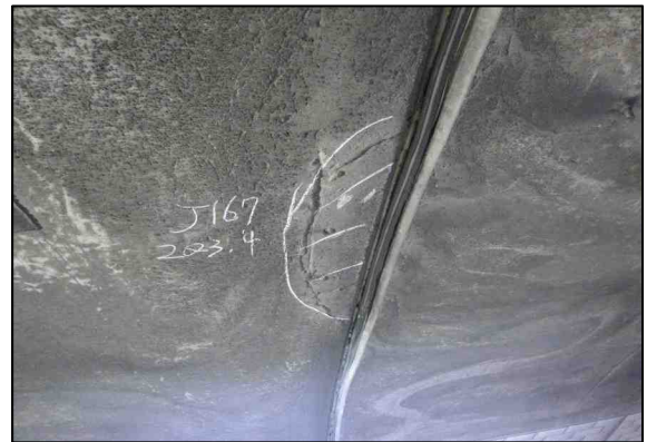
n. 천단부 S167(J167) 시공이음부 박락
