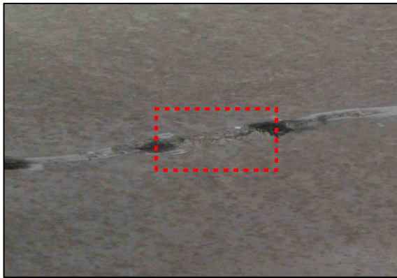
k. 천단부 S79 균열 보수부 박락
