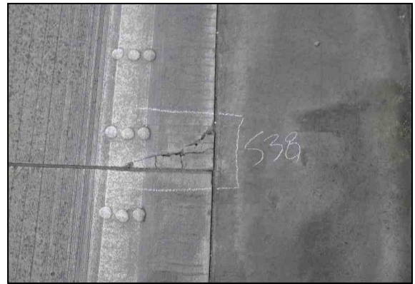
d. 포장부 S38 줄눈 주변 파손
