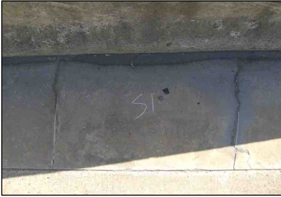
a. 측구 S1 균열(0.3mm 이상)
