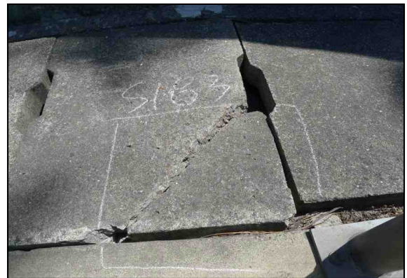
h. 공동구 S183 좌측 덮개 파손
