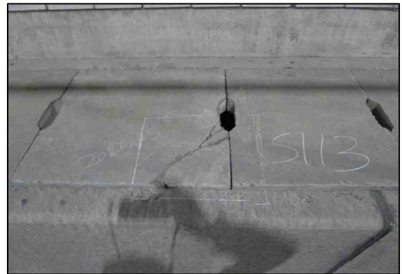
f. 공동구 S113 좌측 덮개 파손
