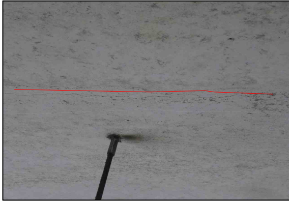
a. 천단부 S5 균열(0.3mm미만)
