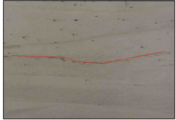
b. 천단부 S18 보수부 재균열(0.3mm미만)
