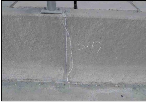
a. 공동구 S17 측면 균열(0.3mm미만)
