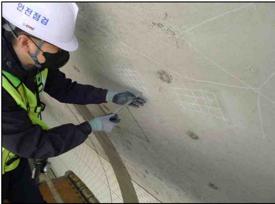
c. 탄산화깊이 측정현황
