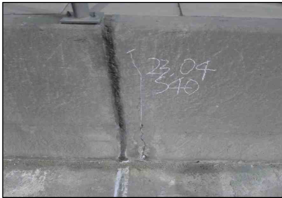
c. 공동구 S40 측면 균열(0.3mm이상)
