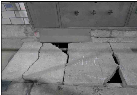
c. 공동구 S160 좌측 덮개 파손
