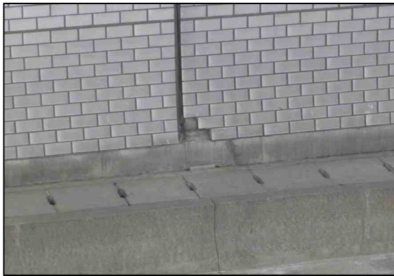
c. 측벽부 S56 좌측 타일탈락, 파손
