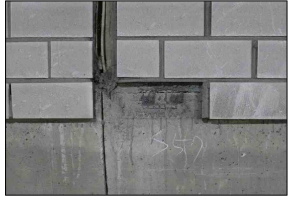
b. 측벽부 S57 우측 타일탈락, 파손
