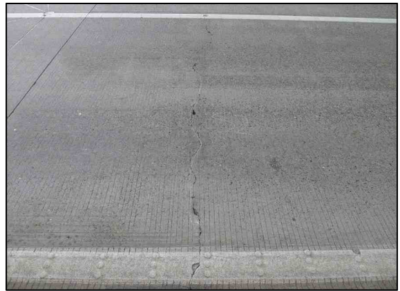
b. 포장부 S2 균열
