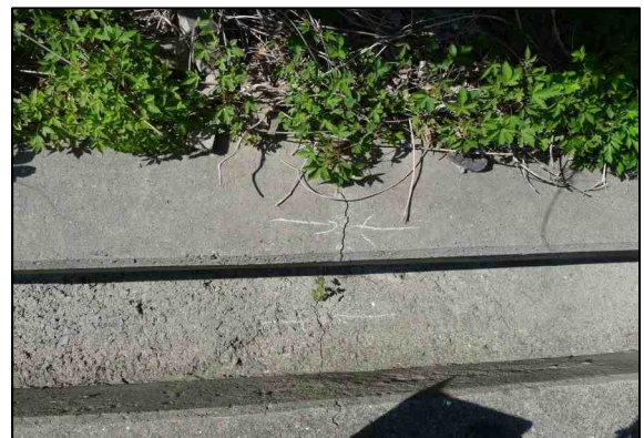
b. 종점부 도수로 균열(0.3mm 이상)
