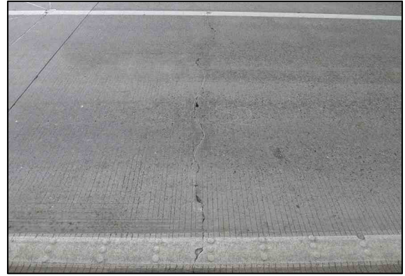
b. 포장부 S2 균열
