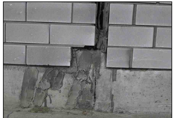
h. 측벽부 S165 우측 타일탈락, 파손
