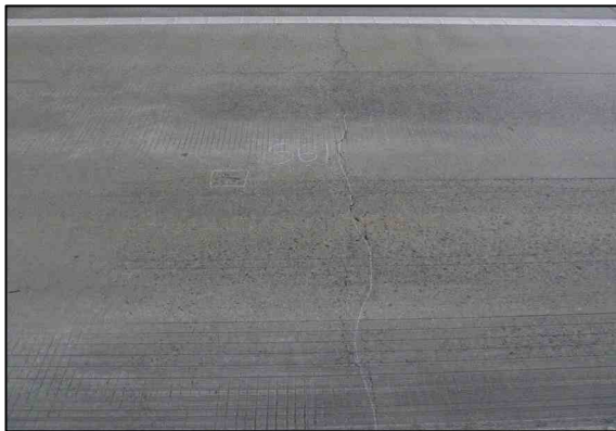
e. 포장부 S61 균열
