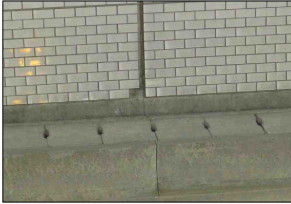
a. 측벽부 S44 좌측 타일탈락, 파손
