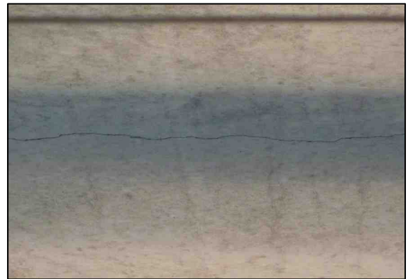
f. 천단부 S62 균열(0.3mm 이상)
