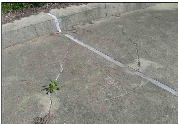
a. 시점부 소단배수로 균열(0.3mm 이상)
